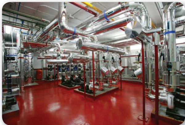
Figura 23. En el ejemplo observamos una sala de climatización inteligente para hospitales que permite una pronta recuperación en varias enfermedades.
