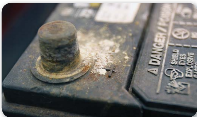
Figura 9. Este tipo de bornes se sulfata muy rápido y puede llegar a dañar el conector si no los limpiamos o revisamos regularmente.
