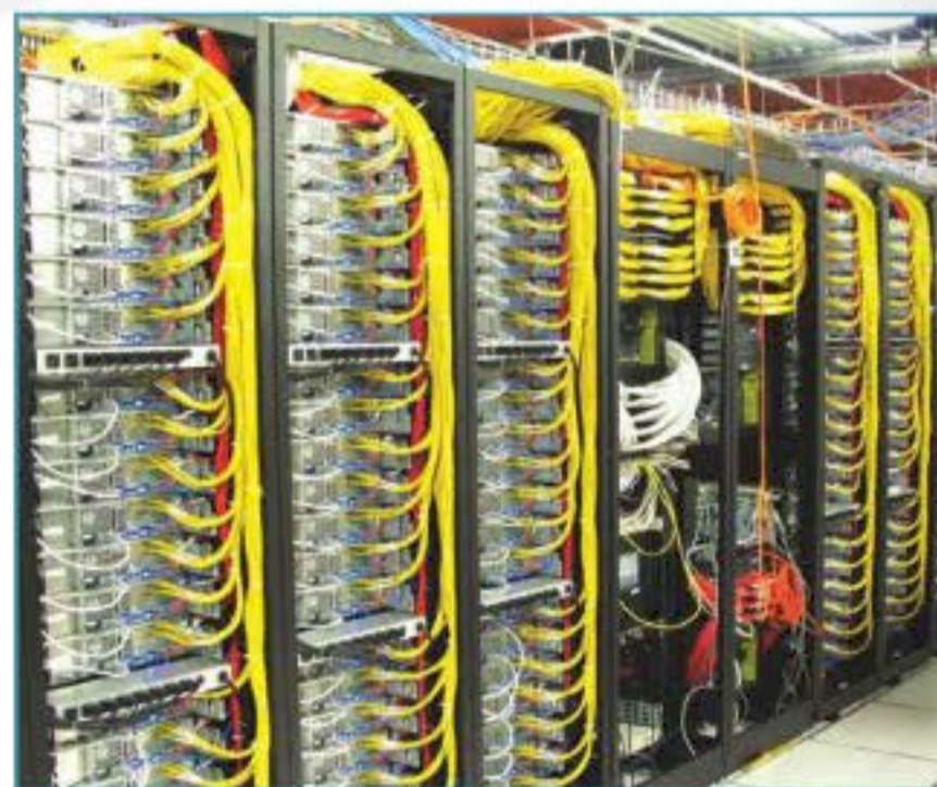
Cableado horizontal que parte desde el cuarto de telecomunicaciones de una empresa.
